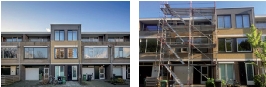
Figuur 15a en b: NOM-renovatie in Zoetermeer; opgeleverd (links) en de buurman in uitvoering (rechts)
